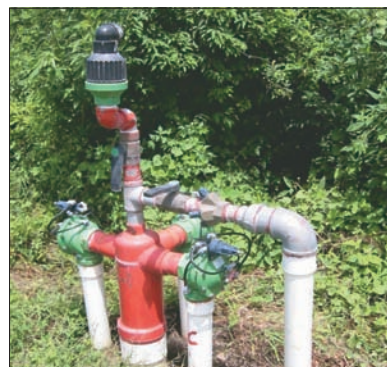
Sistema de Válvulas y llaves.
